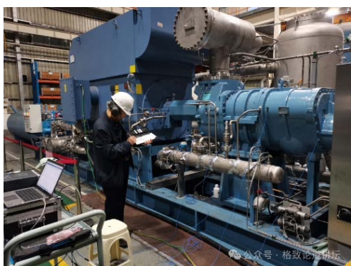
图10 氢气压缩机, 用于国内第一套每天可生产5吨液氢的氢液化器
