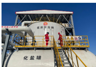
辽河油田电加热熔盐储热供汽示范工程
