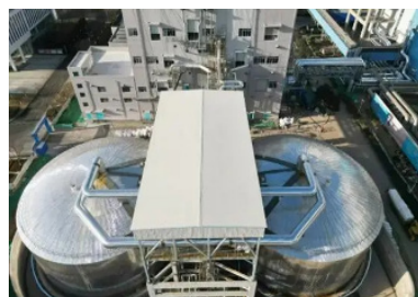
龙山电厂抽汽加热熔盐储热供汽调峰示范工程
