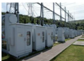
电力通信 户外电柜、箱式变电站、通信设备
