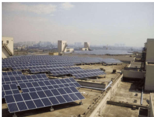
图2.1-5 大型分布式光伏电站
