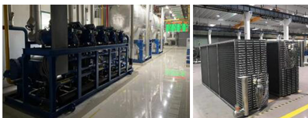
图2 绿色智能农产品保鲜冷库核心系统：制冷机组结构、换热系统结构
