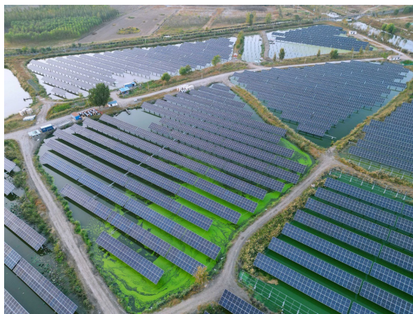
图4.2-7 丹佛斯武清园区自建光伏电站
