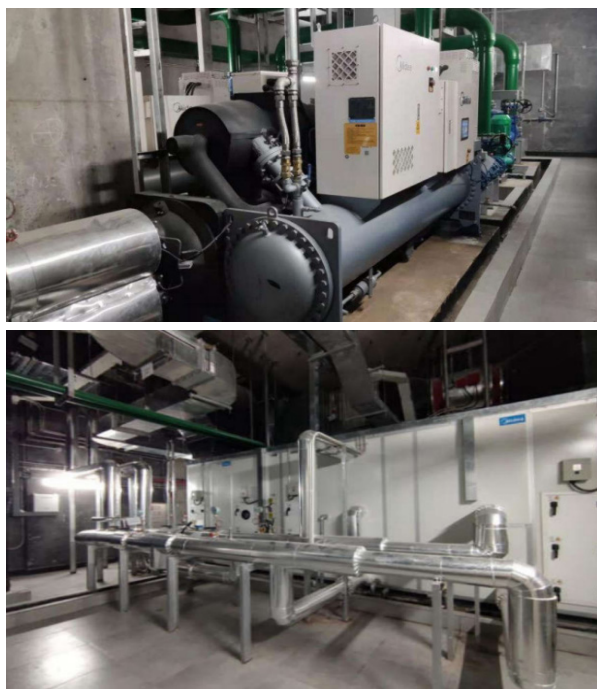
图2.1-8 北滘公园车站中央空调设备机组
