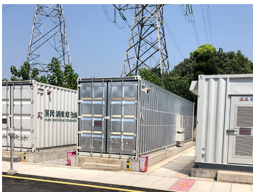
(d) 某储能电站
