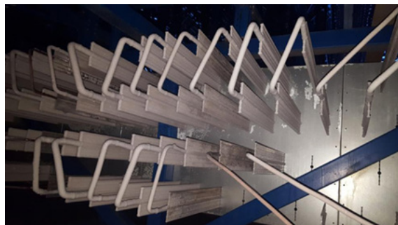
图3.3-10 基于变频控制与翅片顶排管的新型冰温冷库
