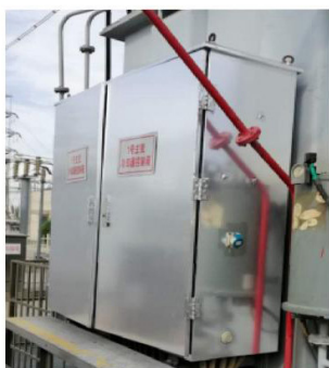
(c) 某330KV变电站风冷控制柜
