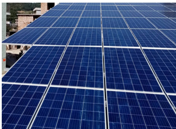
图2 太阳能光伏屋顶
